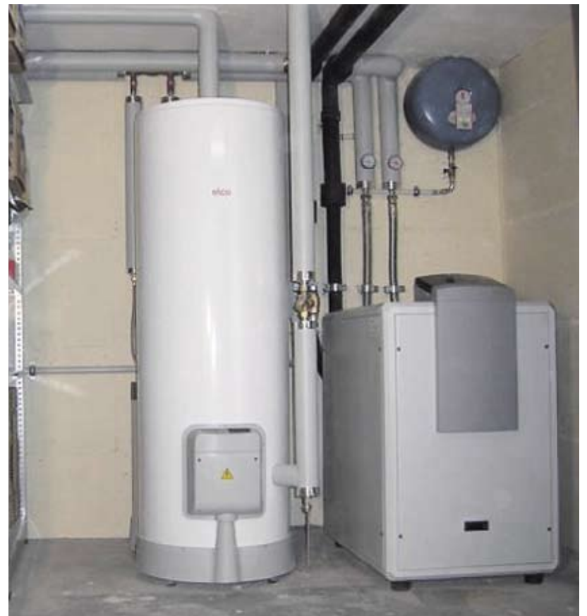
Die Wärmepumpe und der Warmwasserspeicher.
