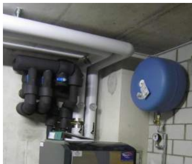
Abb. 6: Erdsondenverteiler sauber gedämmt
