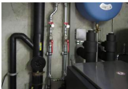
Abb. 1: Nicht gedämmte Leitungen
