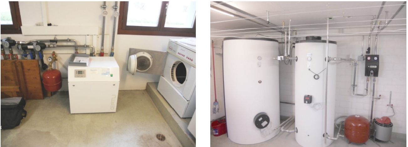
Abb. 5: Anlagen 43 und 71 mit kleinen Mängeln, wie EWS-Zusammenführung ohne richtigen Verteiler und keine Isolation gegen Tropfwasser, sowie Heizleitungen im Heizraum unisoliert montiert.
