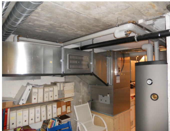
Abb. 3: Anlage 34 LW-WP mit Speicher, ohne WW-Bereitung
