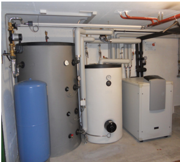
Abb. 2: Anlage 23 SW-WP mit Speicher und Boiler
