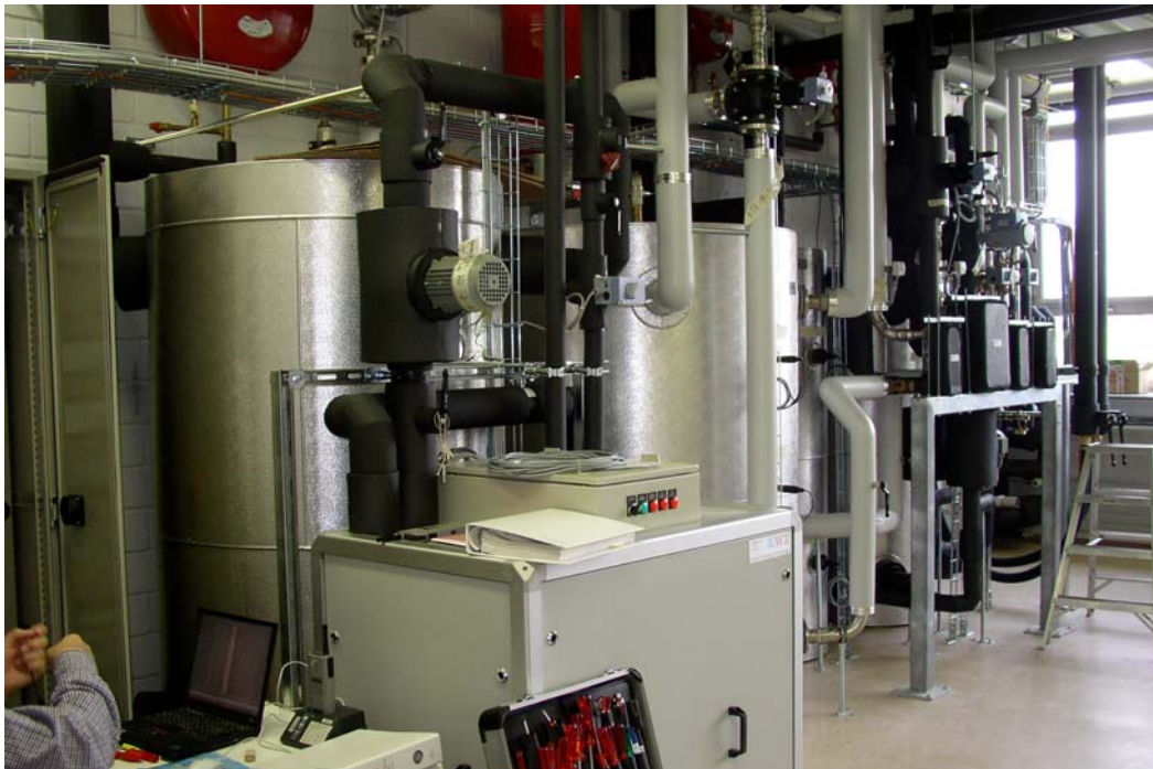
Bild 3: Ansicht des WPZ Buchs: Prüfstand für Sole-Wasser- und Wasser-Wasser-Wärmepumpen.
