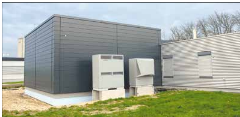
Pour l'entreprise Faivre Energies SA, les formations sur les PAC sont nécessaires afin que chaque planification, installation et mise en service (ici air-eau extérieur) soit optimale au niveau de la production comme de l'environnement direct. COPYRIGHT FAIVRE ENERGIES SA
