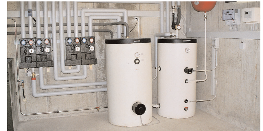
Sur la droite, l'accumulateur tampon de 300l et à gauche, trois groupes distribution à deux niveaux de température et un groupe de charge pour le chauffe-eau de 400l.
