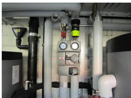
III. 5 ; conduites bien isolées
