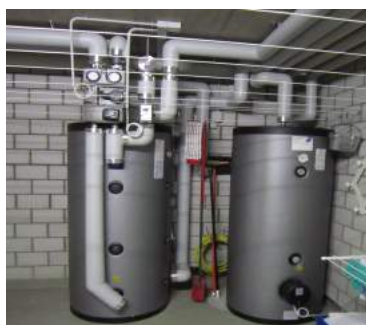
III. 4 : intégration correcte de l'accumulateur
