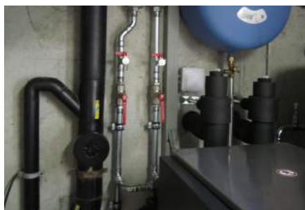
III. 1 : conduites non-isolées
