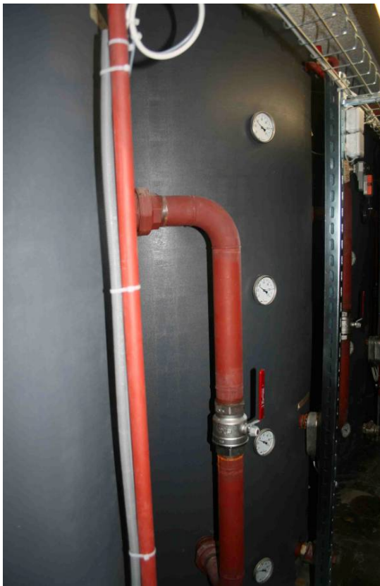
Figure 15 : Ballon de stockage en chaufferie (1'500 L)
