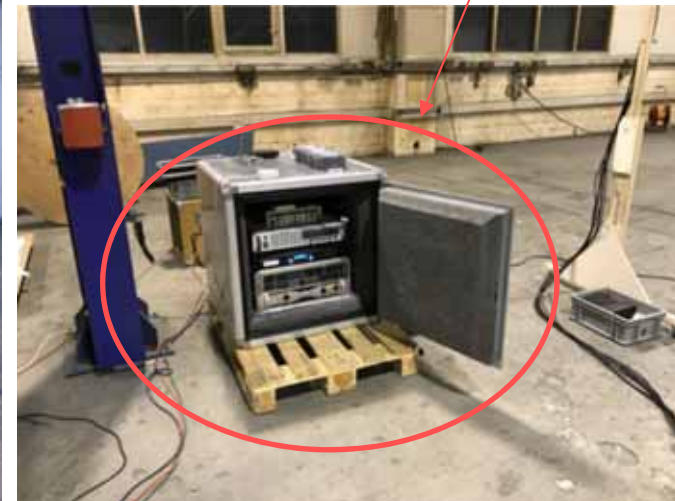
Verhältnismässig laute Geräte in Schalldämmbox
