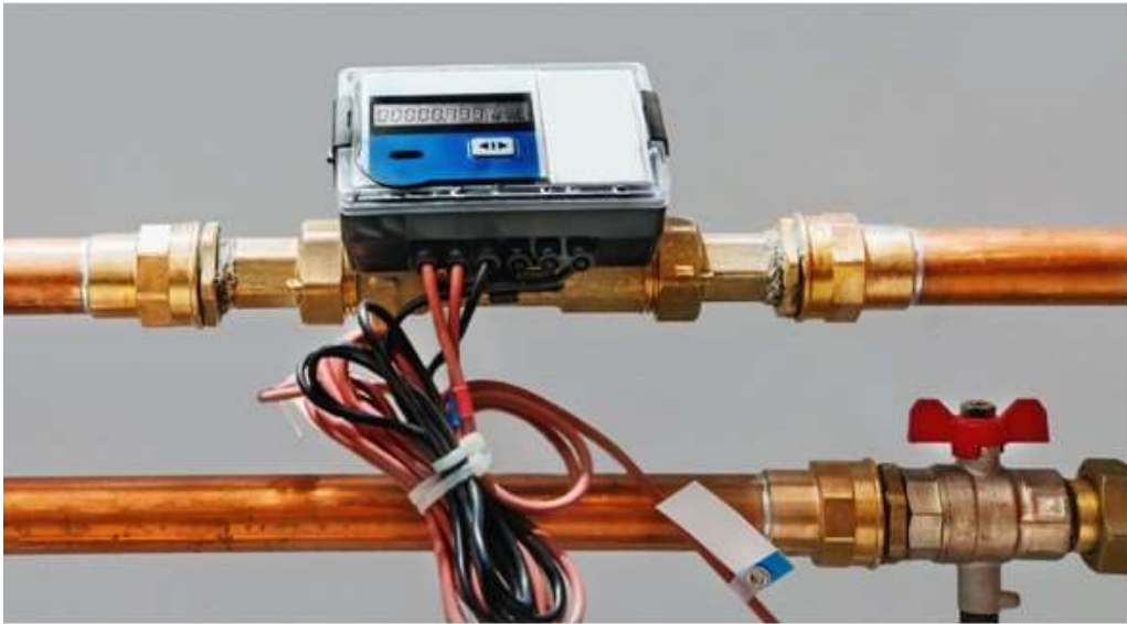
Typischer Wärmezähler (Bild: heizung.de)
