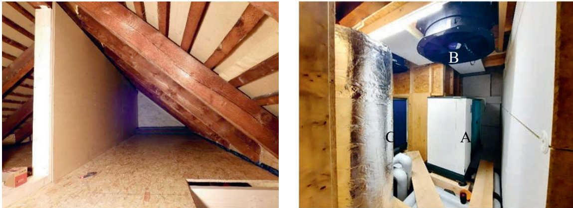
Abbildung 7: Begehbare Luftansaugkanäle unter Dachgiebel (links), Technikraum mit einer der Wärmepumpen (A), einer der Axialventilatoren (B) und dem gedämmten und beheizbaren Ausdehnungsgefäss (C) (rechts)
