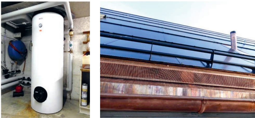
Abbildung 8: Warmwasser-Speicher im Keller (links), Wärmepumpen-Luftansauggitter über der Regenrinne im Solardach (rechts)
