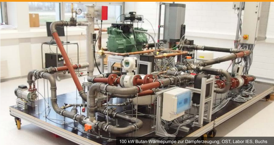
100 kW Butan-Wärmepumpe zur Dampferzeugung, OST, Labor IES, Buchs
