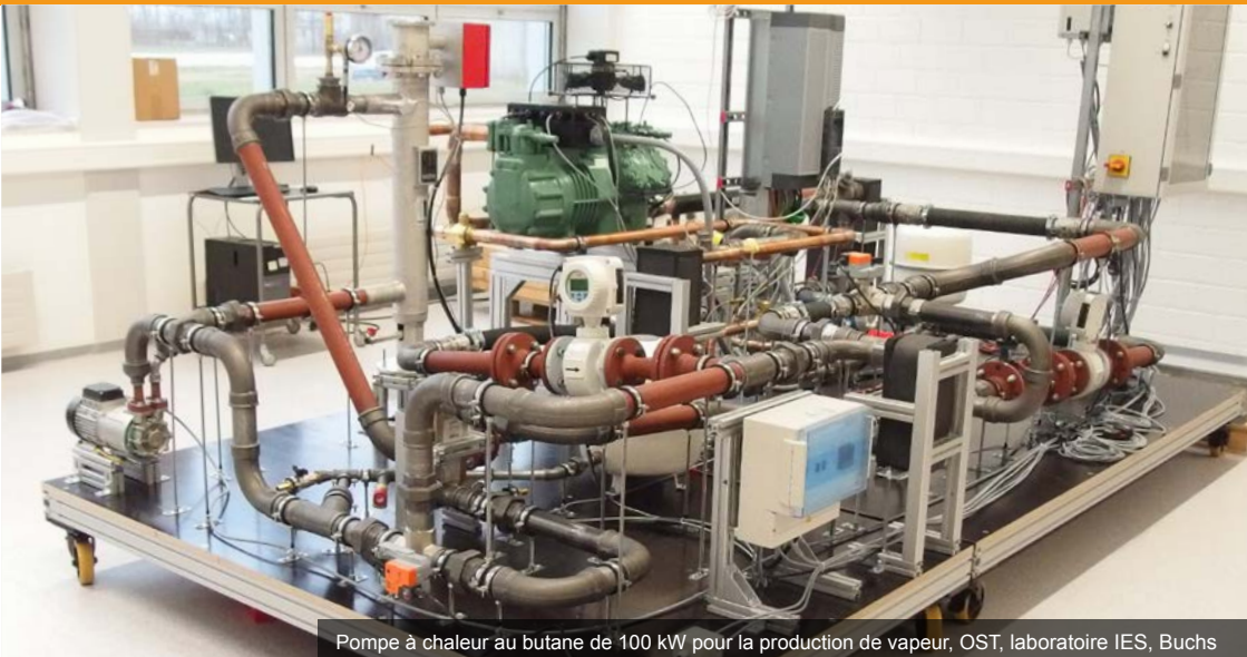
Pompe à chaleur au butane de 100 kW pour la production de vapeur, OST, laboratoire IES, Buchs
